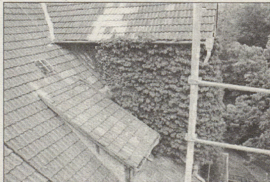
Burg-Rückseite zu Baubeginn im August (Efeubewuchs, kaputte Dachrinnen und -kästen, marode Dachfläche)
