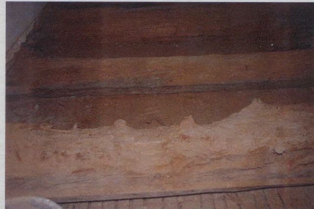
Stark vermoderte Deckenbalken im 1.OG Nordturm im Bereich der geplanten Küche
